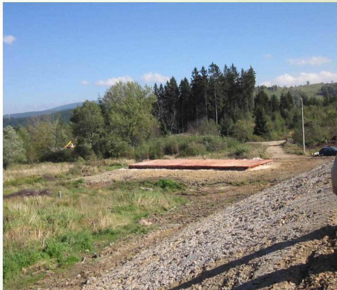
Zberná nádrž priesakovej kvapaliny
